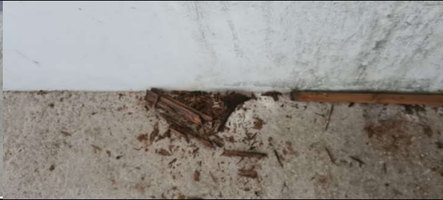
Parti di finestra che si staccano continuamente
