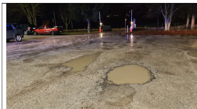
Alcune pozzanghere del piazzale
