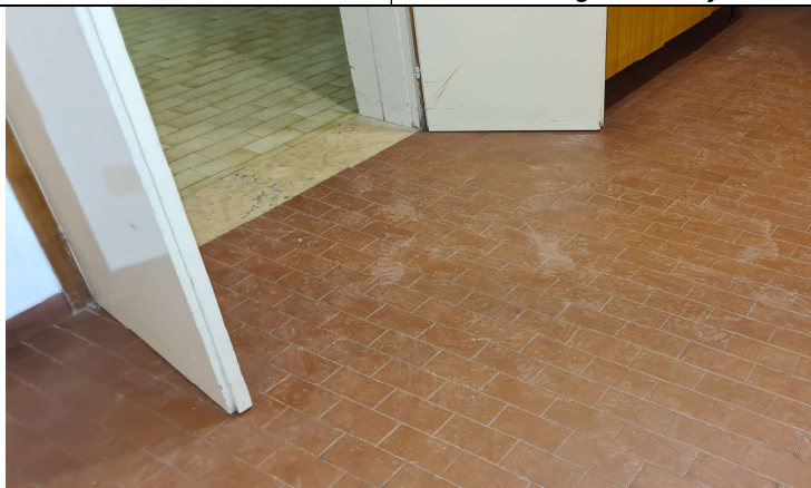
Sporco portato all'interno della caserma transitando dalla rimessa
