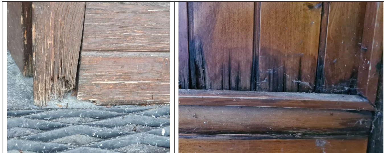
Stato telaio bussola d'ingresso con parti di legno marcio
