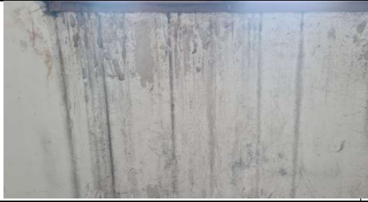
Segno delle infiltrazioni d'acqua
