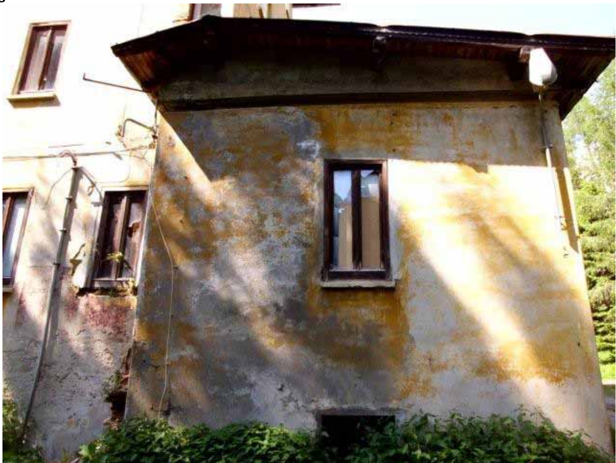
Figura 22: L'ESTERNO DELLO STABILE, SI EVIDENZIA CHE GLI INFISSI, NONOSTANTE CHIUSO DA ANNI, SEMBRANO ANCORA IN BUONO STATO.
